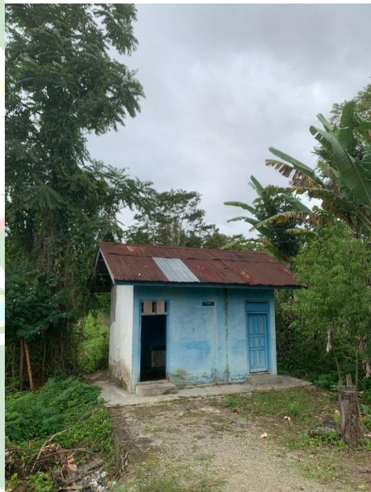
kondisi WC sekolah
